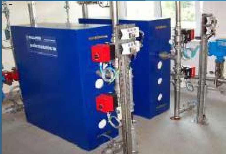
Equipamento instalado na planta de Bamberg (Alemanha)
