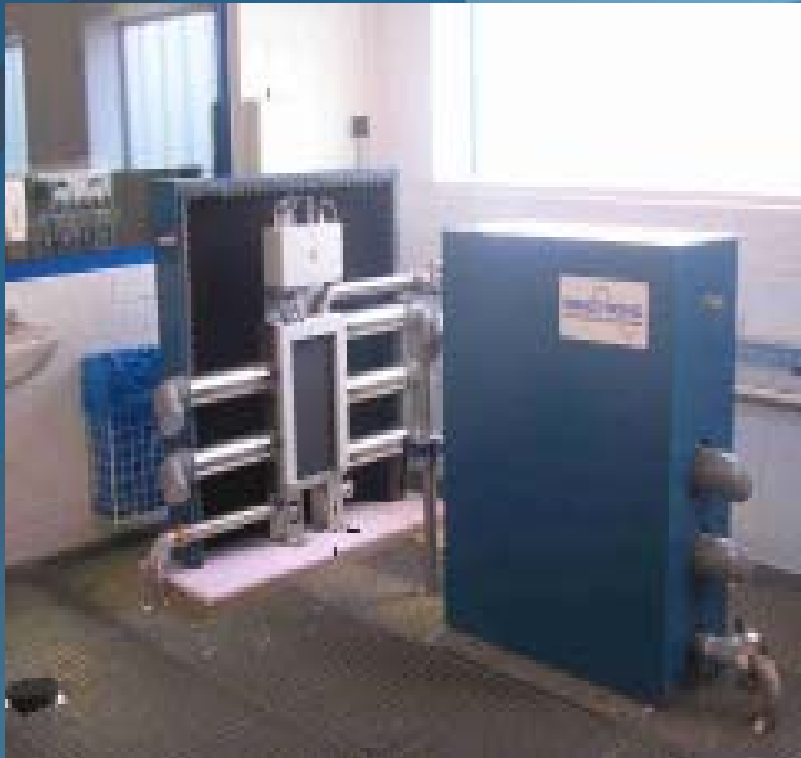
Equipamento instalado na planta de Meldorf (Alemanha)
