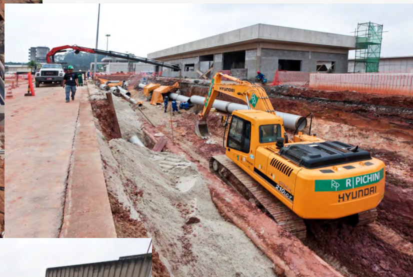
Adutora na ETE – agosto de 2011
