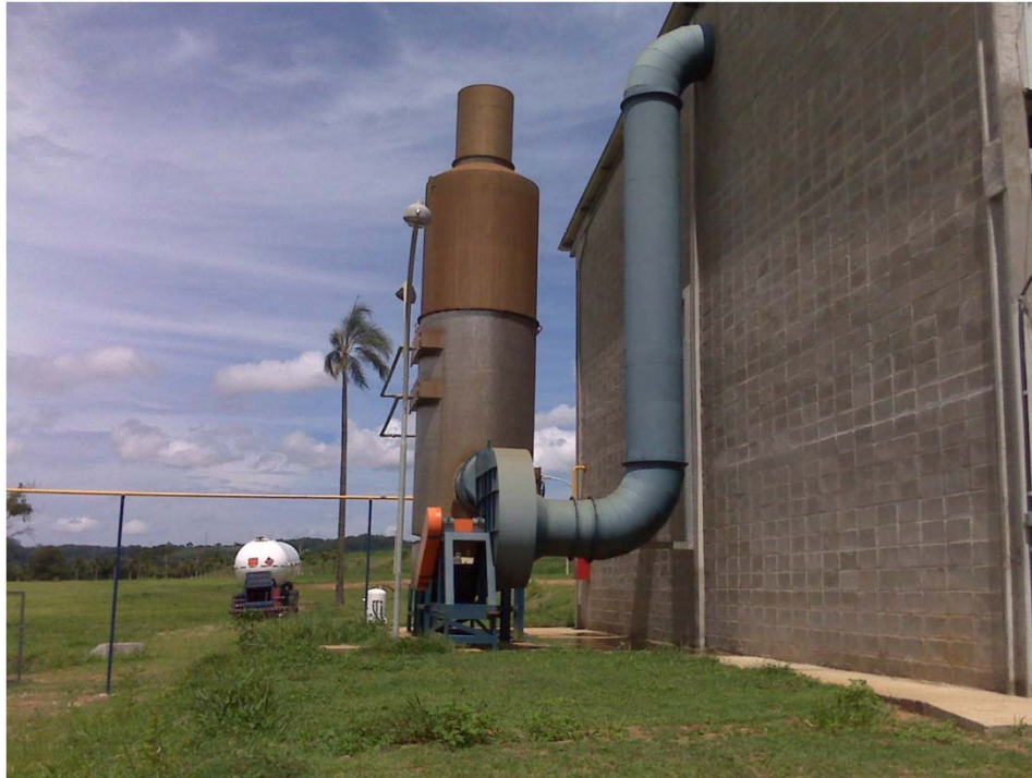
← Sistema de Lavagem de Gases
