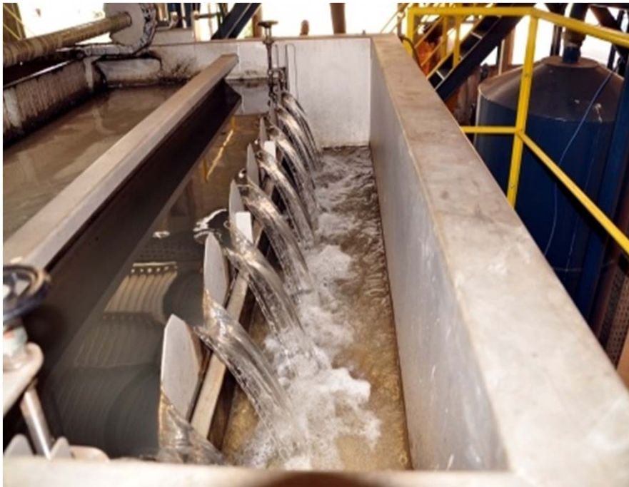
← Saída do Clarificado no Flotador FAD
