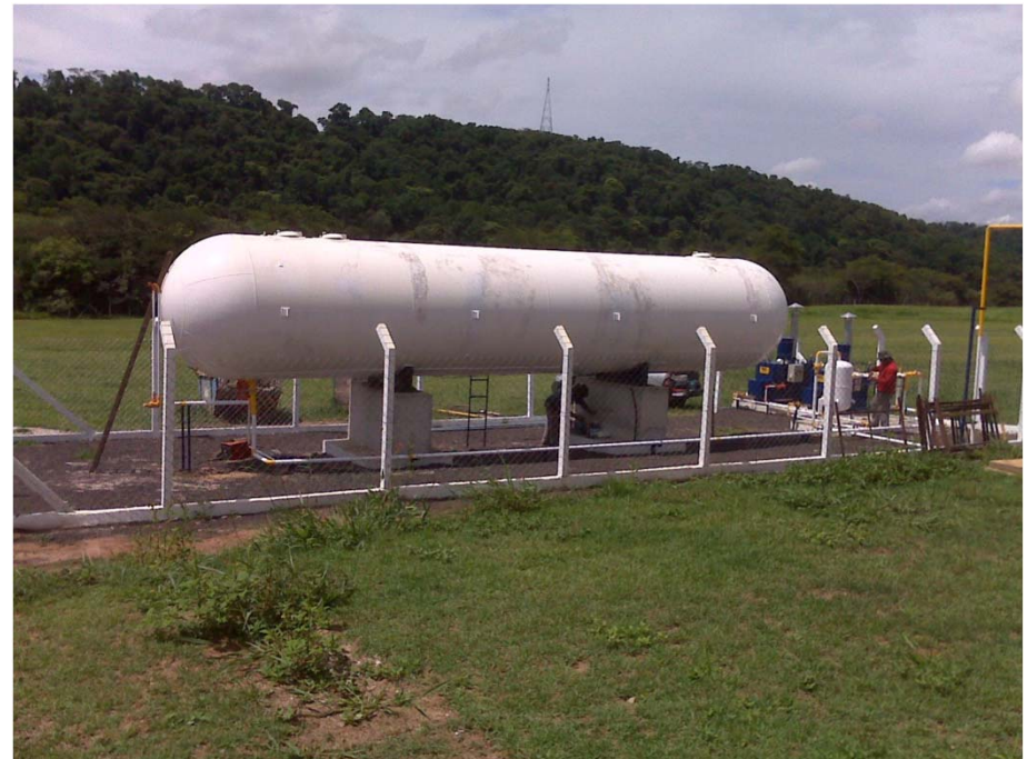
Reservatório do Gás GLP →
