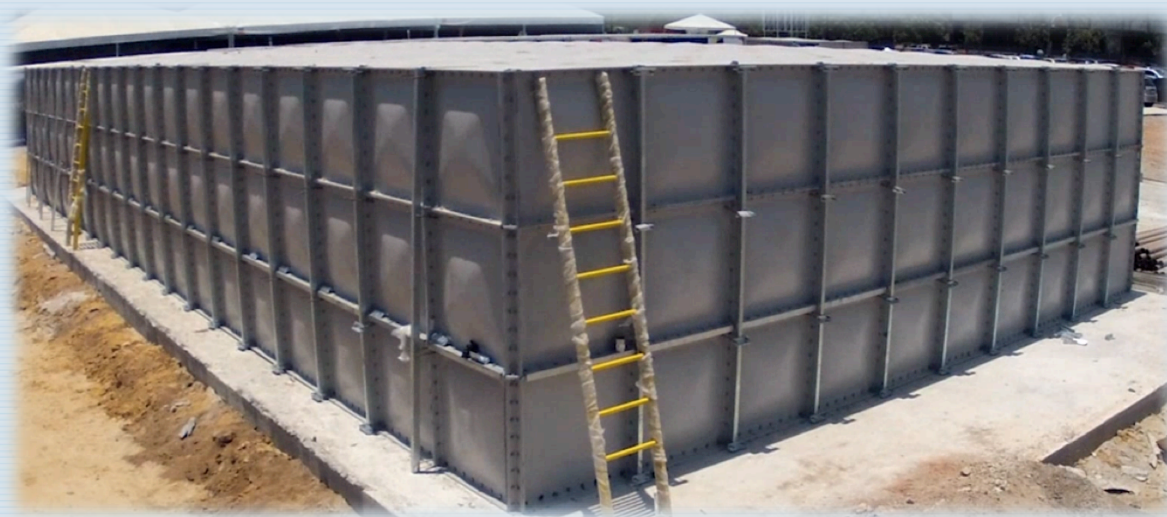
Tanque de 600 mil litros, Vila Olímpica – Barra da Tijuca/RJ
