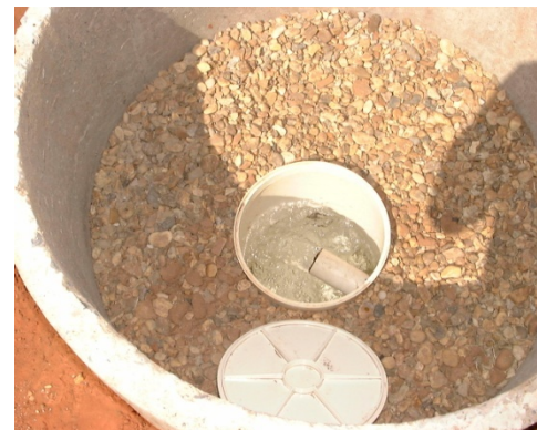
Caixa de passagem
