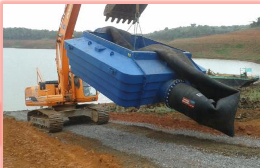
Detalhe da motobomba com mangote flexível acoplado
