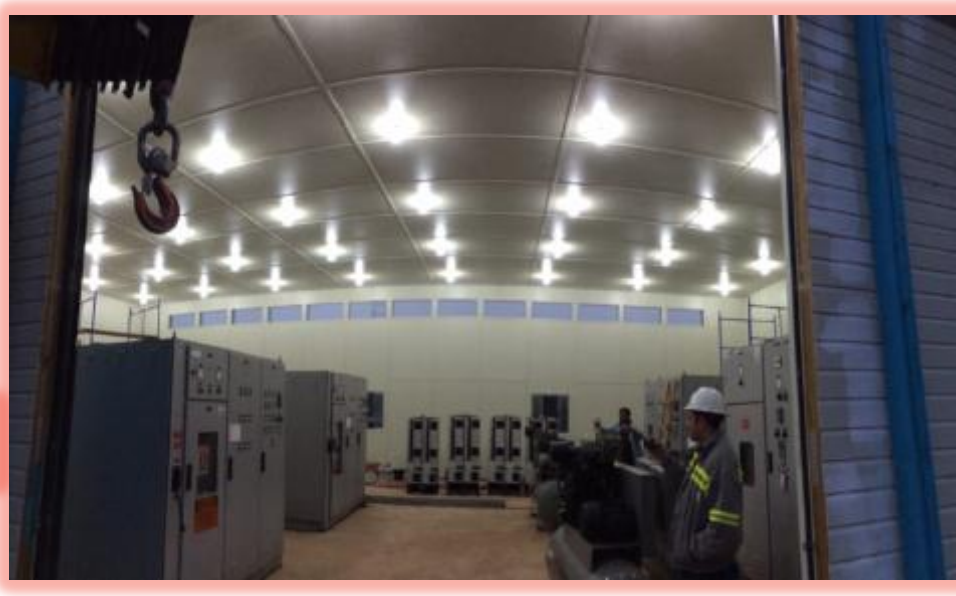
Interior da sala de painéis
