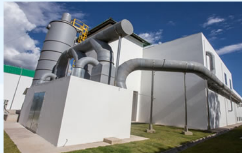
ETE Campos do Jordão Q= 213 l/s – Tratamento Terciário
