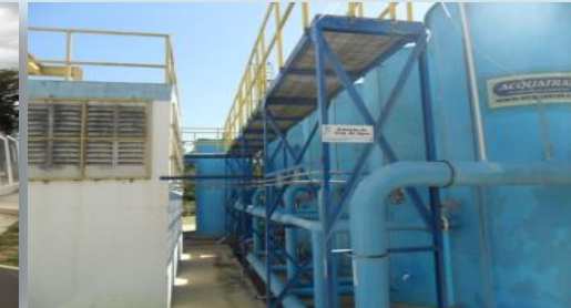
ETA Sorocamirim / RM Município de São Roque Q=15 l/s
