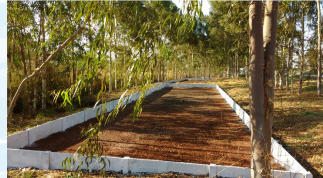
Vala de Infiltração da ETE – Distrito Arabá Município de Ouroeste Plantação de eucaliptos juntos as Valas de Infiltração para evitar saturação beneficiando uma população de 730 habitantes
