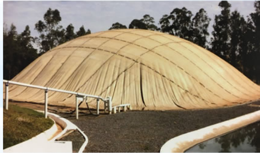
ETE Auriflama Captação de gás para iluminação
