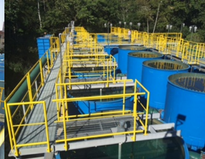
ETA Guaxinduba / RN Município de Caraguatatuba Ampliação + Q=150 l/s
