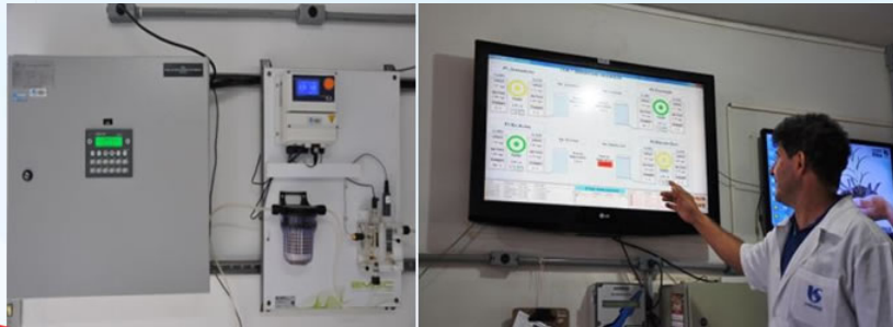
Sistema de Monitoramento de Cloração à Distância
