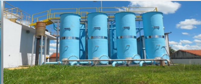
ETA Riolândia / RT Município de Riolândia Q=15 l/s
