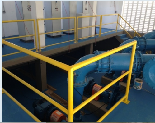
Elevatória de Água Tratada
