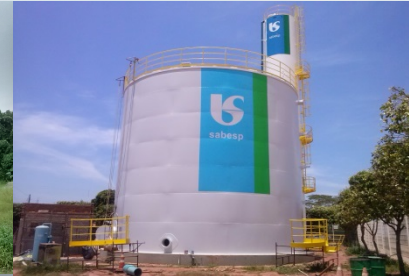
Reservatório Sede Município de Fernandópolis Metálico Cap. 1.000m 3
