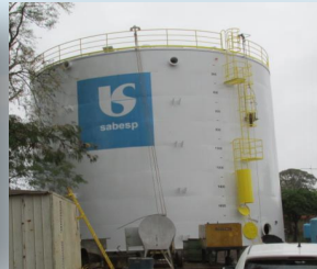
Reservatório Avaré Metálico Cap. 2.000m 3
