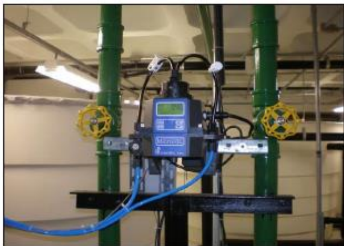
Figura 3 – Automação (Turbidímetro on-line)
