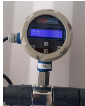
Medidor de vazão
