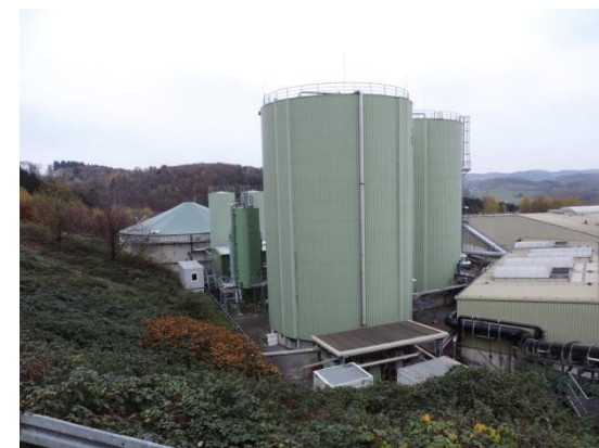
Unidades de Biodigestão
