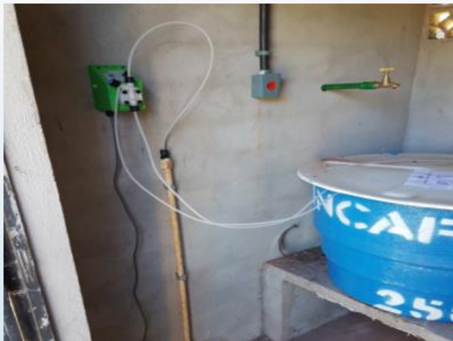
Tratamento com Bomba Dosadora
