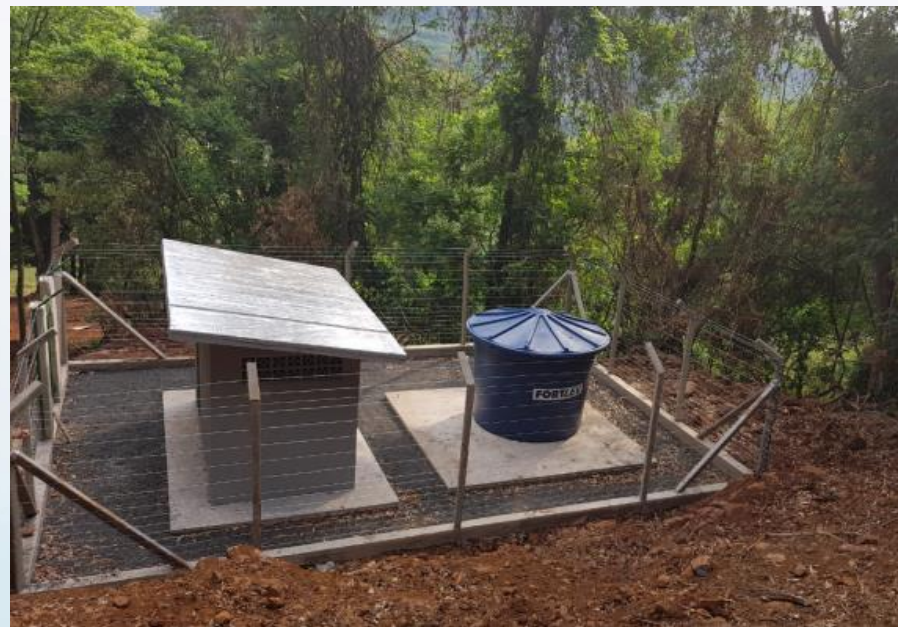
Elevatória com reservatório apoiado
