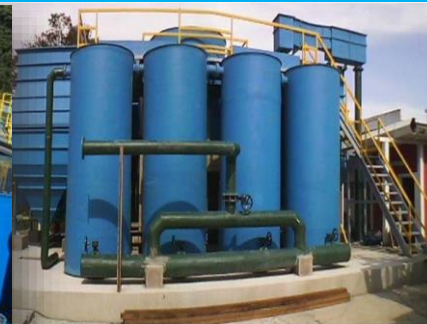
ETA Paiol do Meio / RR Município de São Lourenço da Serra Q=15 l/s
