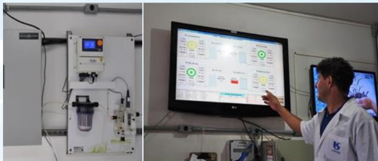
Sistema de Monitoramento de Cloração à Distância
