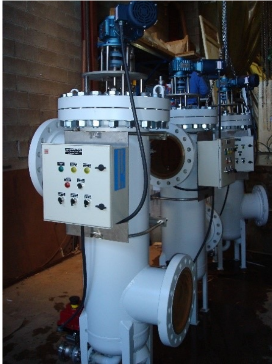
Diavik Diamond Mine – Filtro ACME usado no processo de desaguamento. Localização: Canadá
