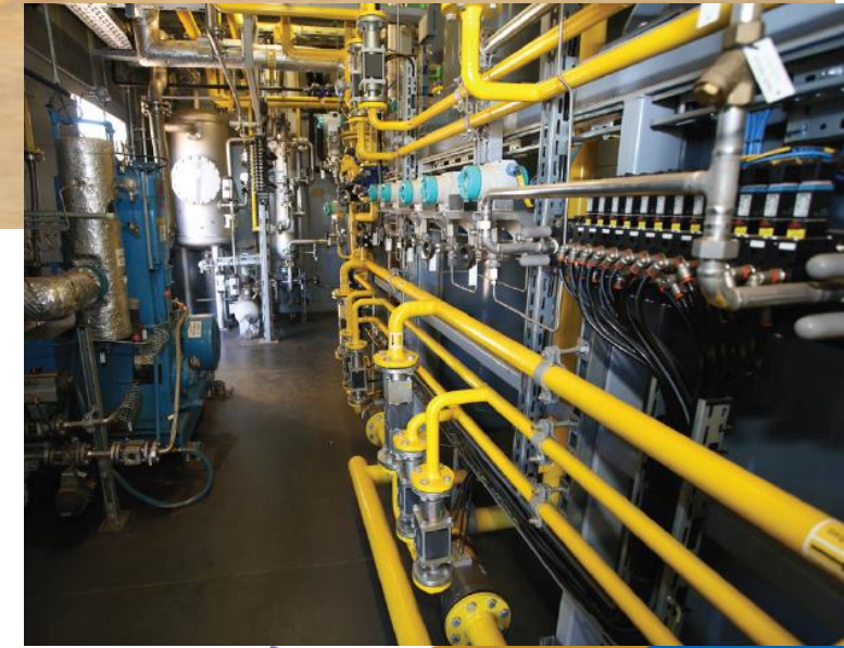
Unidade de beneficiamento do biogás - ETE Franca
