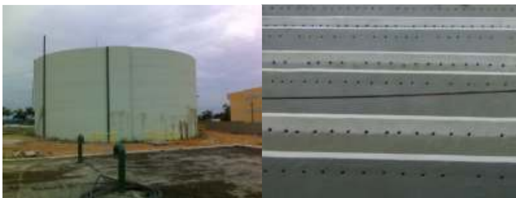
Foto 1 – Vista de Infiltração de reservatório
