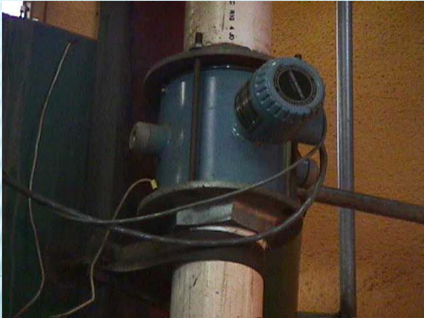
Figura 2: Vista do medidor eletromagnético.
