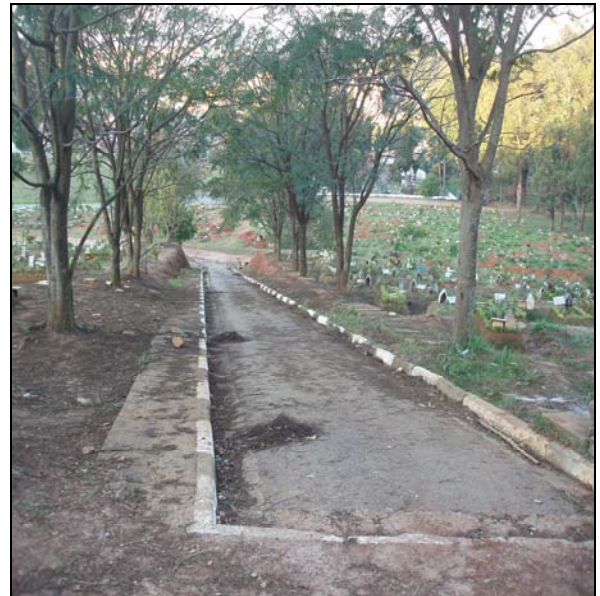
Fig. 4.6 – Vista do Cemitério de Itaquera (SP), onde se nota declividade relativamente acentuada (até 40%) em área asfaltada, que, juntamente com a natureza areno-argilosa, favorece a erosão do terreno. (2007).
