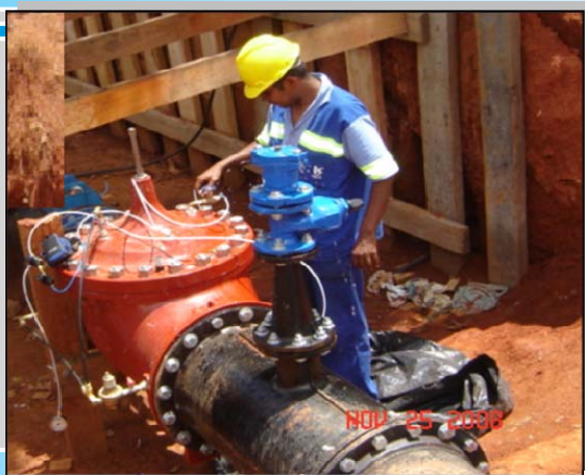
VRP's com controlador
