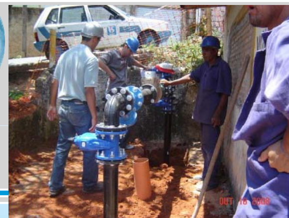
VRP's instaladas em cavalete
