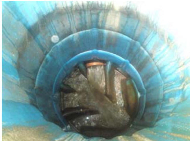
Figura 20 - Poço instalado em funcionamento há vários anos
