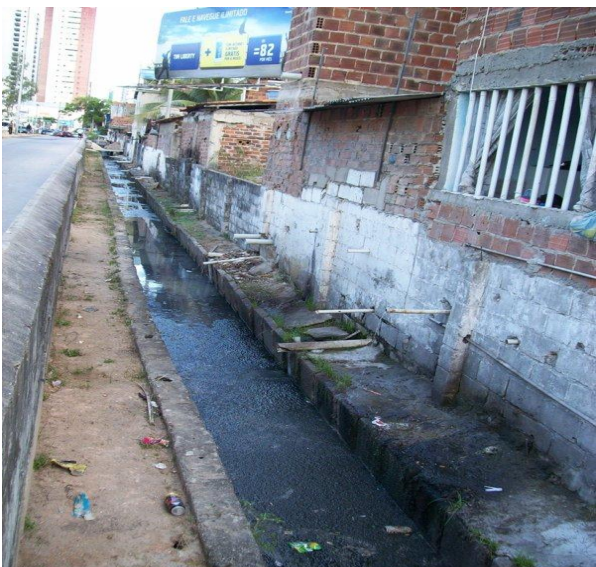
Figura 2: Canal para drenagem ao lado do Shopping.
