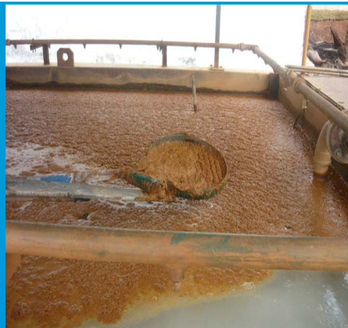
Coletor de superfície para amostragem do lodo da ETA Mairiporã
