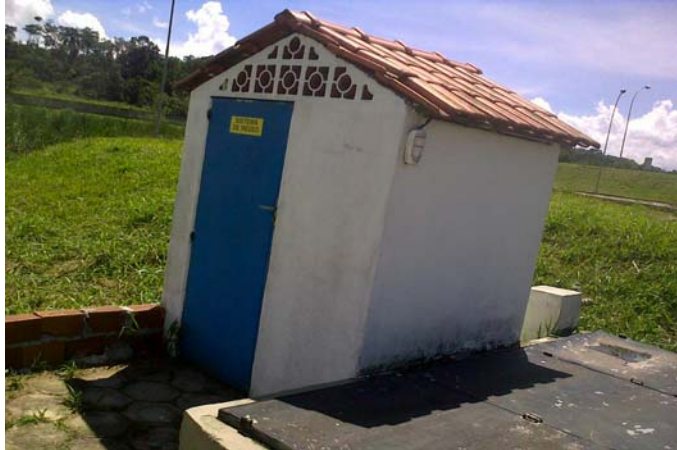
Foto 6 Abrigo do medidor secundário
