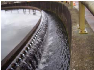
Foto 11: Vertedores dos Decantadores Secundários de onde se coletaram amostras.
