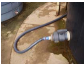
Foto 3: Tomada de Sucção do Sistema de Recirculação.
