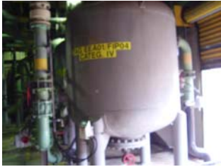
Foto 10: Filtro de Areia e Antracito.
