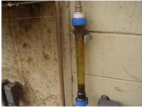
foto 5: Rotâmetro para medição de vazão antes da lâmpada UV.
