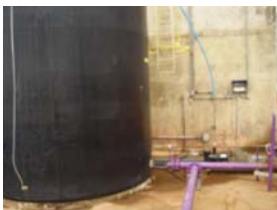
Foto 2: Sistema de Retorno com Bomba de recirculação e mangueira de nível.
