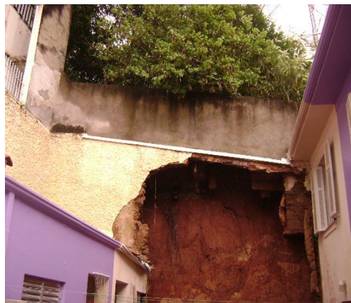
Figura 3 – talude e residências atingidas
