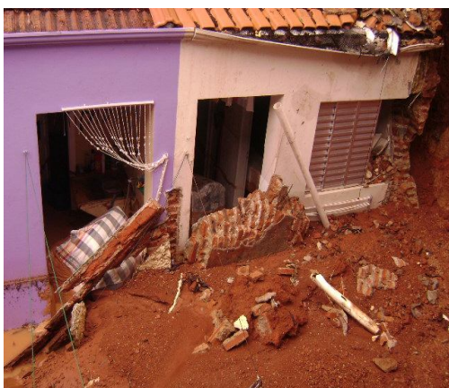
Figura 6 – Residências Atingidas (exterior)
