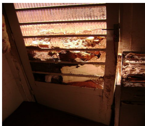
Figura 7 – Residência Atingida (interior)
