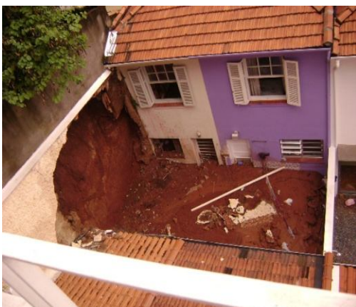
Figura 4 – vista superior do talude e residências atingidas
