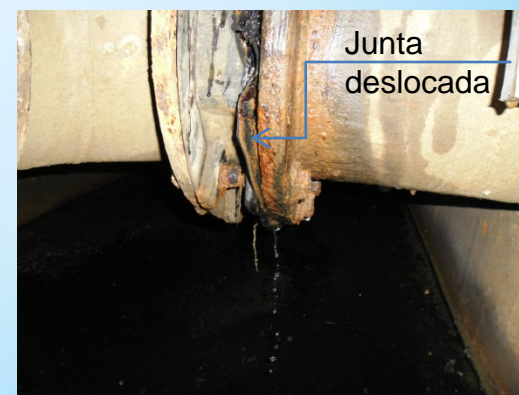
Detalhe do vazamento
