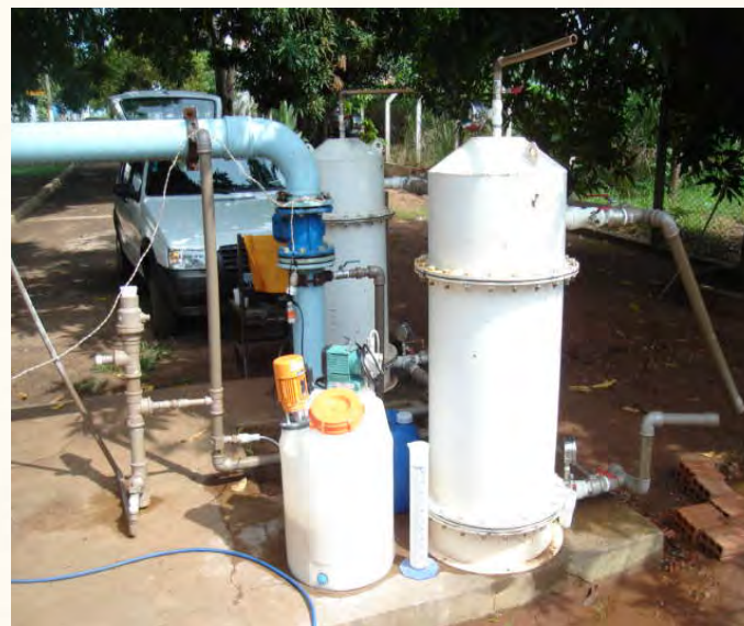
Fig. 09 – Vista do by-pass instalado no barrilete do PTP 012
