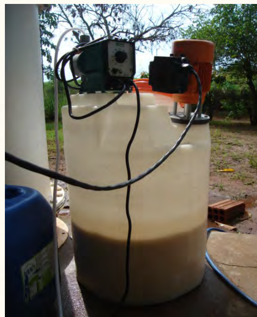
Fig. 13 – Tanque de preparação e dosagem de alcalinizante.
