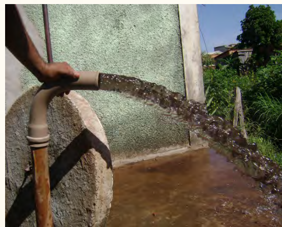
Fig. 07 – Cor turva da água no ponto de descarga.
