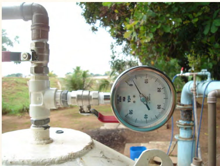
Fig. 14 – Manômetro, monitoramento da perda de carga dos filtros.
