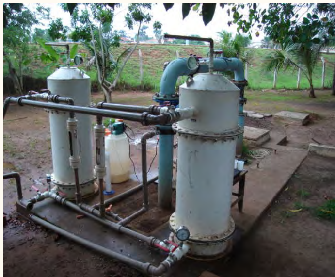
Fig. 08 – Vista do protótipo instalado próximo ao PTP 012
