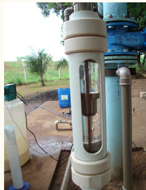
Fig. 15 – Rotâmetro, controle de vazão nos filtros.
