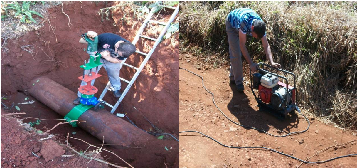
Figura 04: Execução de furação de tubulação em carga para implantação de 12 ventosas na AAB Rio Pato Branco. Fonte: Acervo do autor, 2010.
