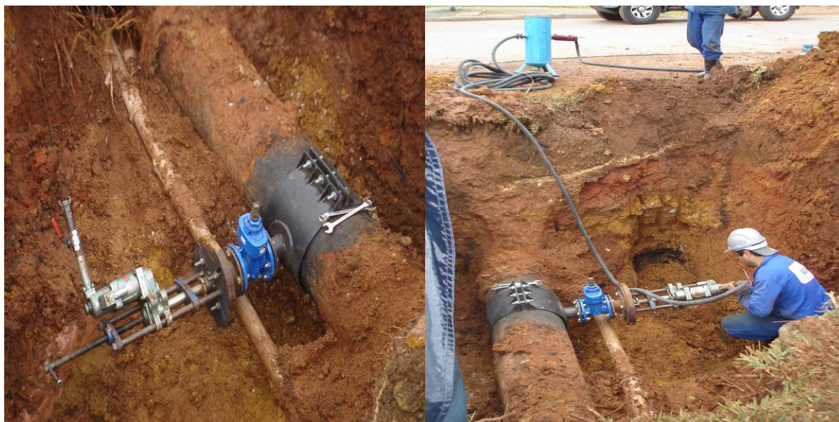
Figura 02: Acompanhamento de furação de tubulação em carga para implantação de hidrante. Fonte: Acervo do autor, 2010.
