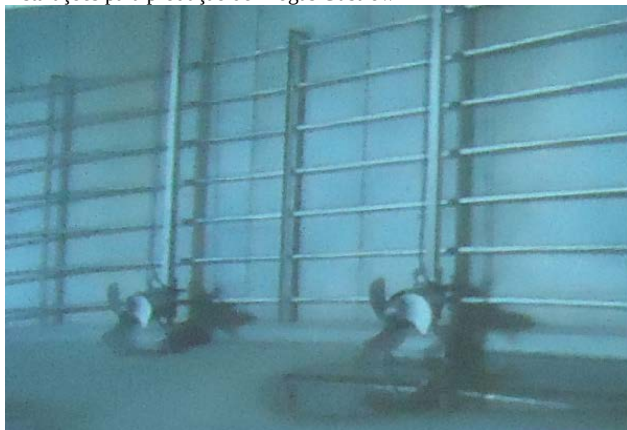
Visão interna dos misturadores dos biodigestores
