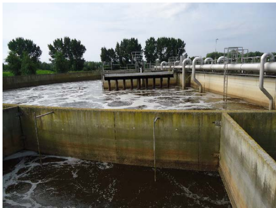
Tanques de Aeração
