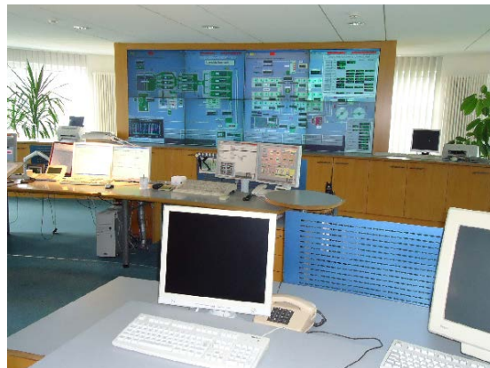
Centro de Controle da ETE
