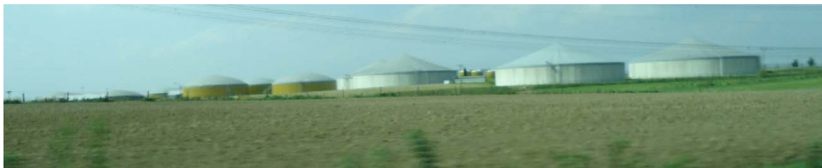
Instalações para produção de Biogás Güstrow
