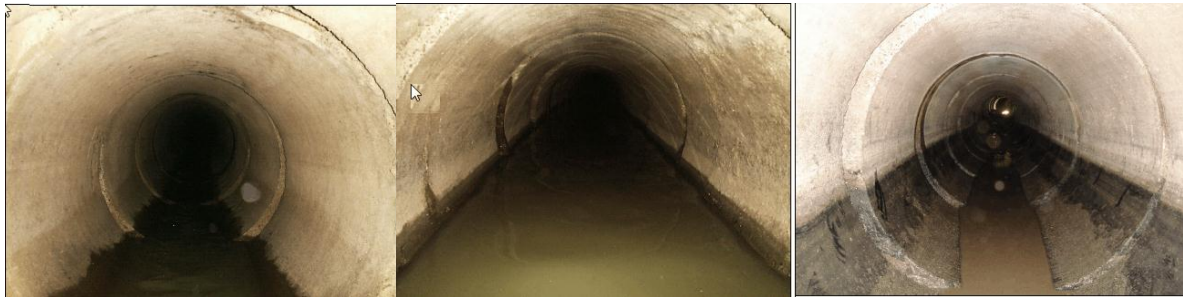
Figura 9 – Ilustração de falhas em tubulações rígidas por subsidência .
