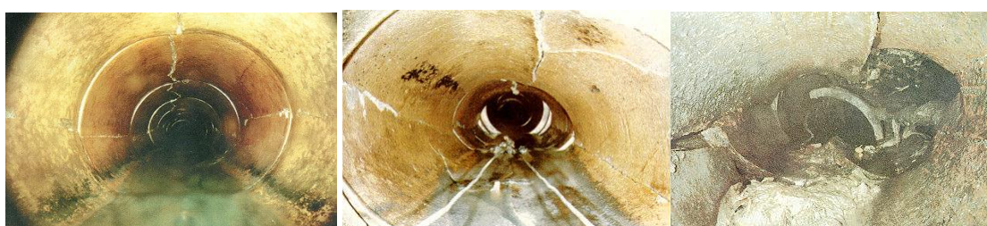
Figura 7 – Ilustração de falhas em tubulações rígidas por deformação progressiva.
