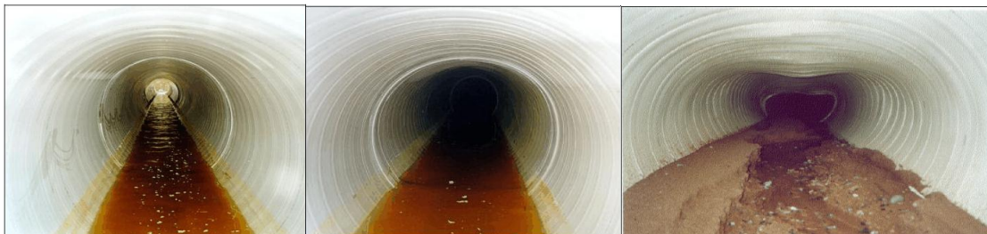
Figura 11 – Reversão de curvatura - Deformação progressiva (tubo recém-instalado, após 2 semanas e apresentando início de reversão de curvatura)
