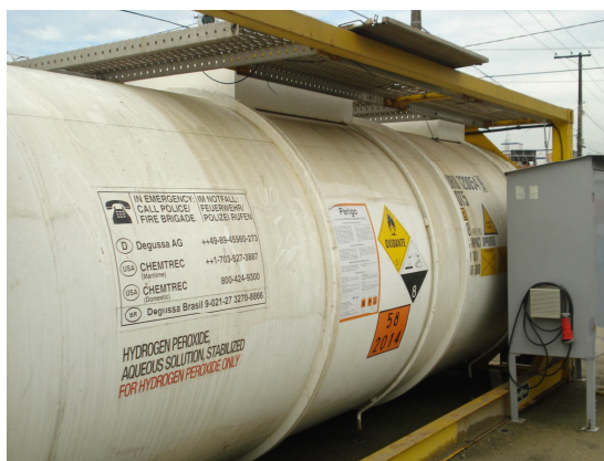
Figura 6 - Sistema de estocagem e dosagem de Peróxido de Hidrogênio
