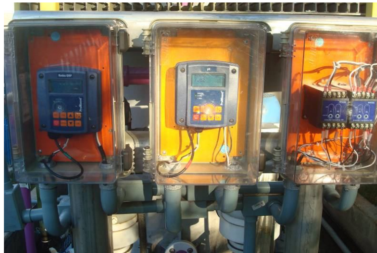
Figura 10 – Equipamentos de controle da Torre Lavagem – EPC Santos
