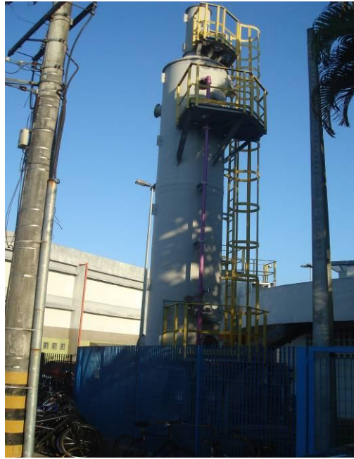
Figura 9 – Torre de lavagem de gases - EPC de Santos
