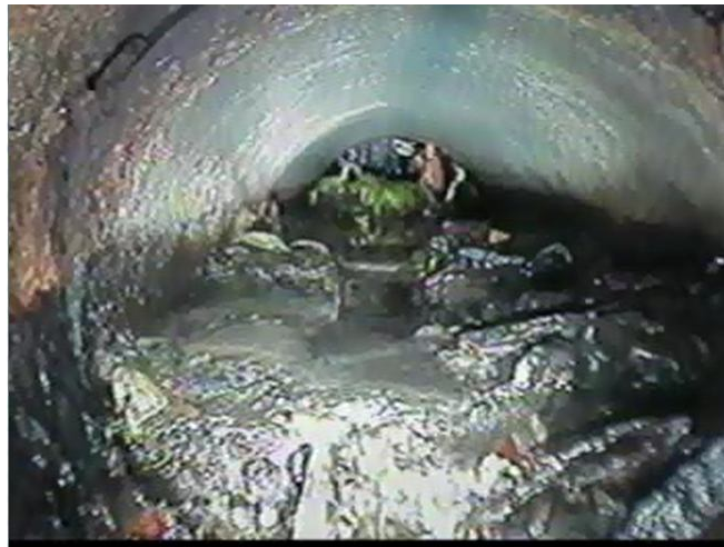
Figura 2 - Coletor de Esgoto - Rua Ministro João Mendes - Santos - Obstruído
