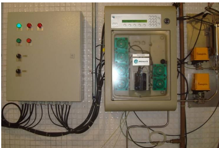
Figura 11 – Analisador de Sulfeto em solução líquida instalado na EPC Santos – Metrohm/Pensalab
