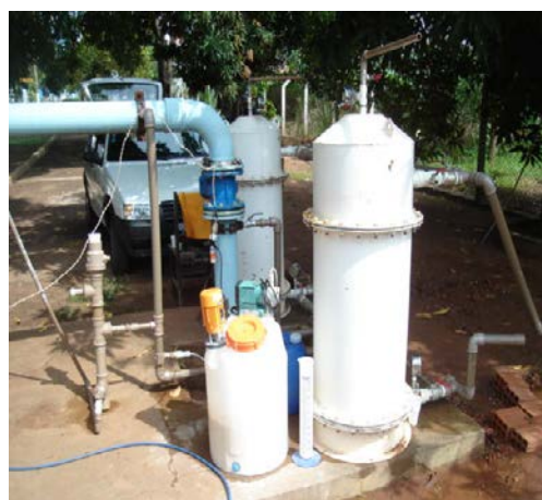
Figura 02 – Vista do by-pass instalado no barrilete do PTP 012.
