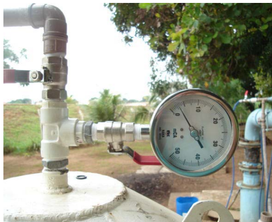
Figura 06 – Manômetros instalados nas tubulações de entrada e saída dos filtros.
