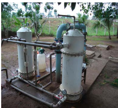
Figura 01 – Vista do protótipo instalado próximo ao PTP 012.
