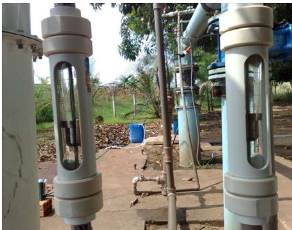
Figura 05 – Rotômetros utilizados para medição da vazão de entrada dos filtros.
