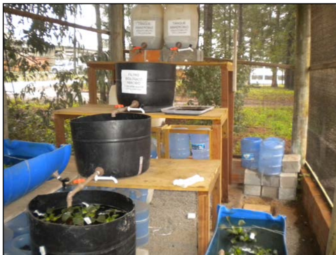
Figura 2 – Sistema de Tratamento constituído de tanque séptico, filtros aeróbios e banhado construído – Escala reduzida.
