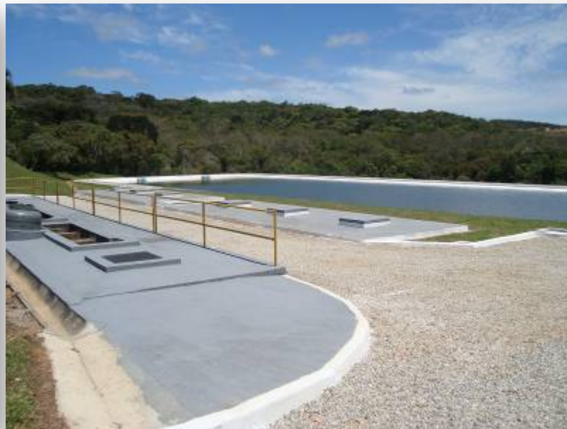
Tratamento preliminar (gradeamento e caixa de areia) com armazenamento de resíduos após aplicação de auditoria housekeeping.
