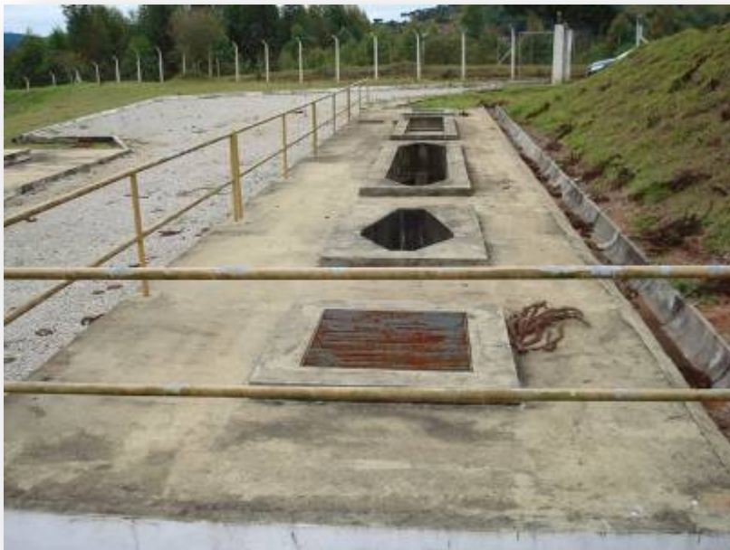
Tratamento preliminar (gradeamento e caixa de areia) sem armazenamento de resíduos antes da aplicação de auditoria housekeeping.
