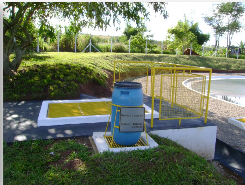
Lagoa anaeróbia e caixas de entrada com armazenamento de resíduos após aplicação de auditoria housekeeping.
