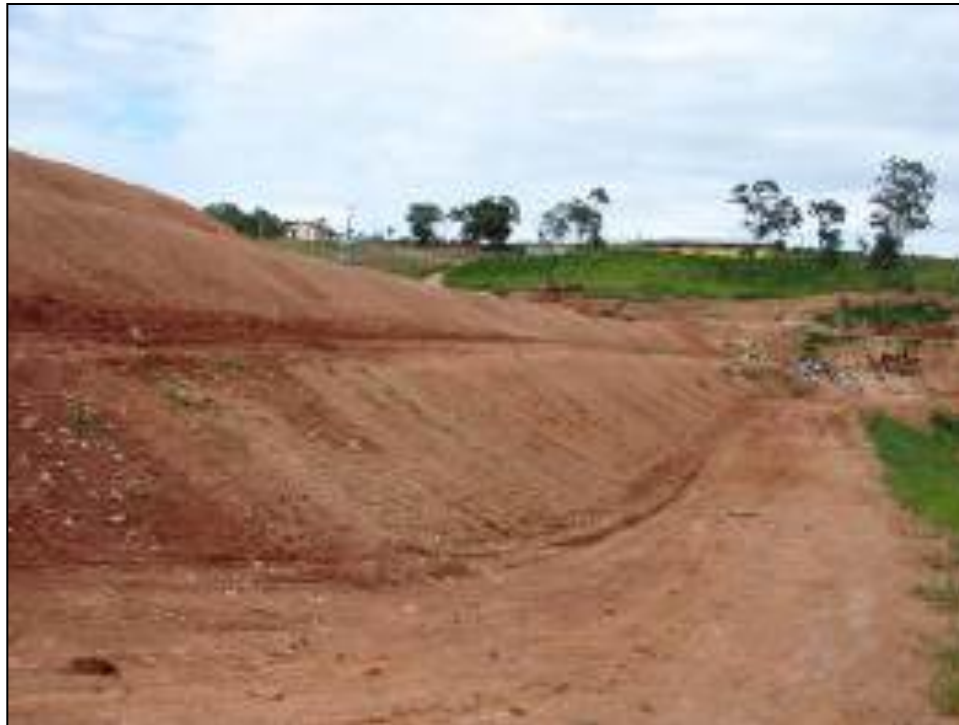
Foto 4 – Vista geral do aterro sanitário com a primeira e segunda camadas preenchidas e com recobrimento final em terra, restando apenas a necessidade de plantio de grama e a implantação do sistema de drenagem de águas pluviais.
