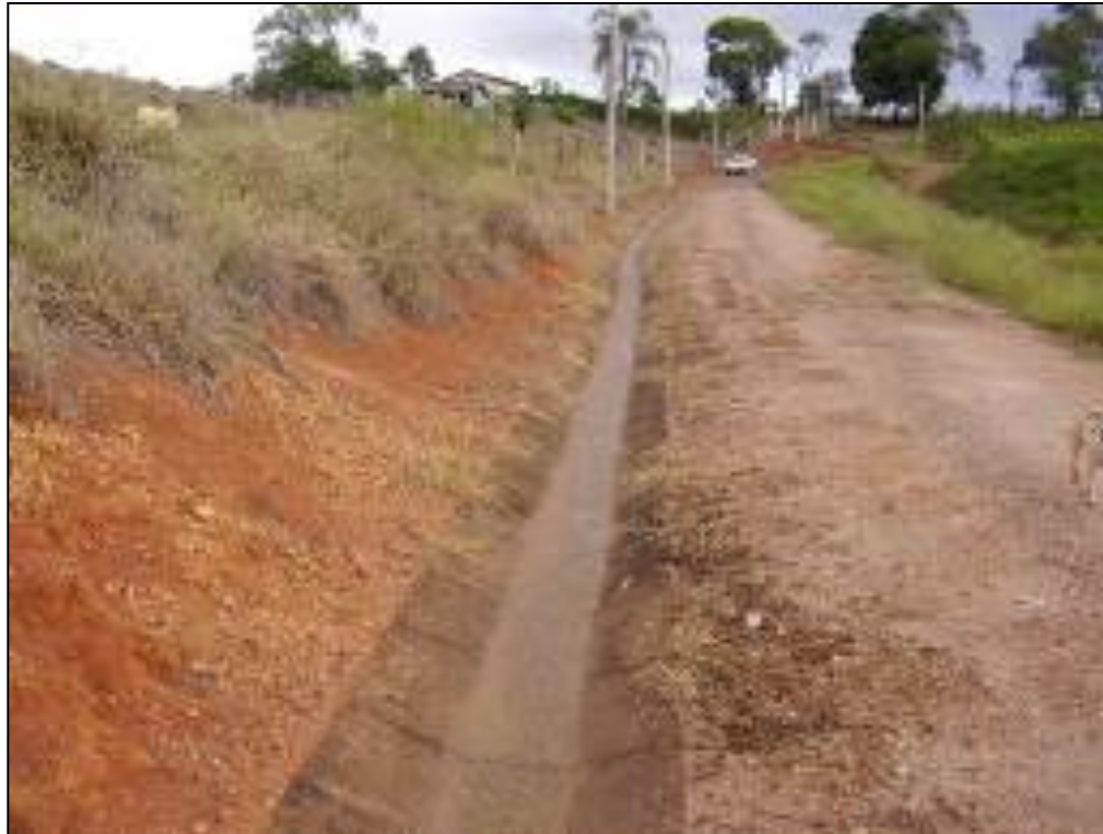
Figura 16 – Vista geral da canaleta de águas pluviais e da estrada de acesso à 1ª célula, de jusante para montante.
