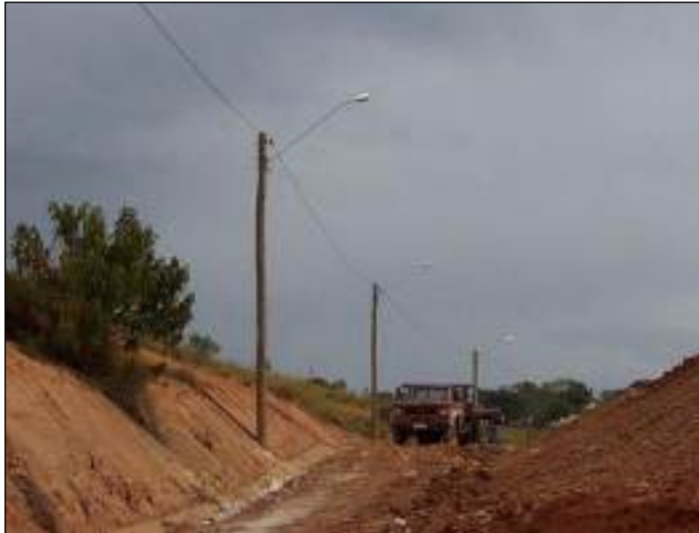
Figura 18 – Vista parcial dos postes de iluminação.
