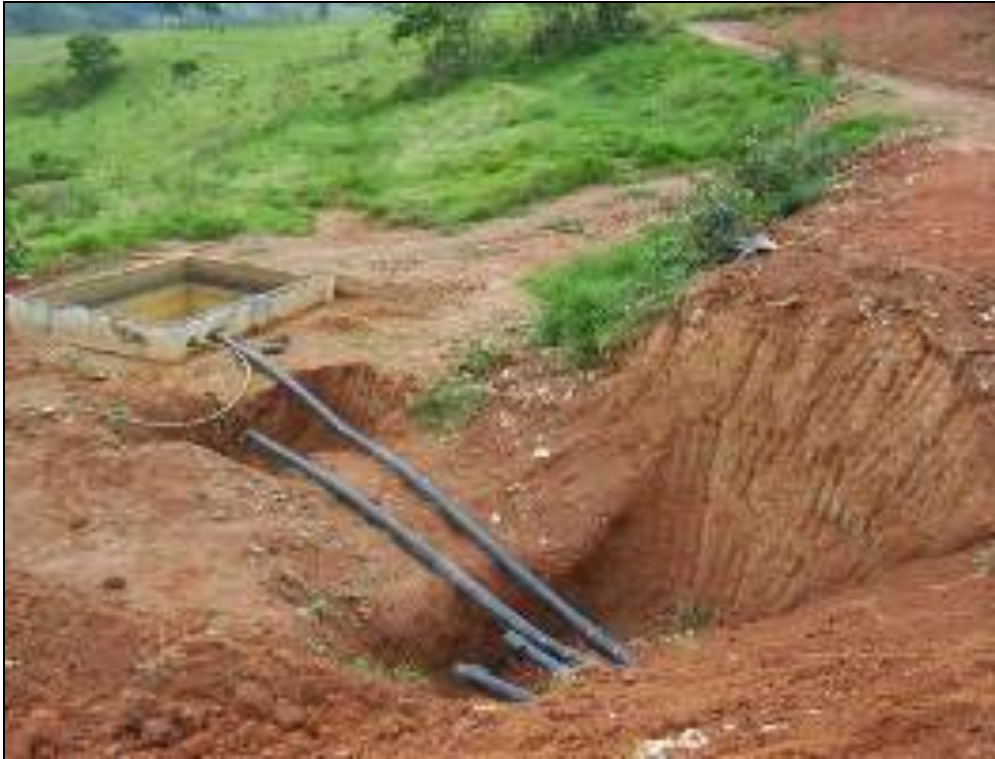
Foto 9 – Detalhe da interligação dos drenos do aterro sanitário e do tanque de acúmulo
