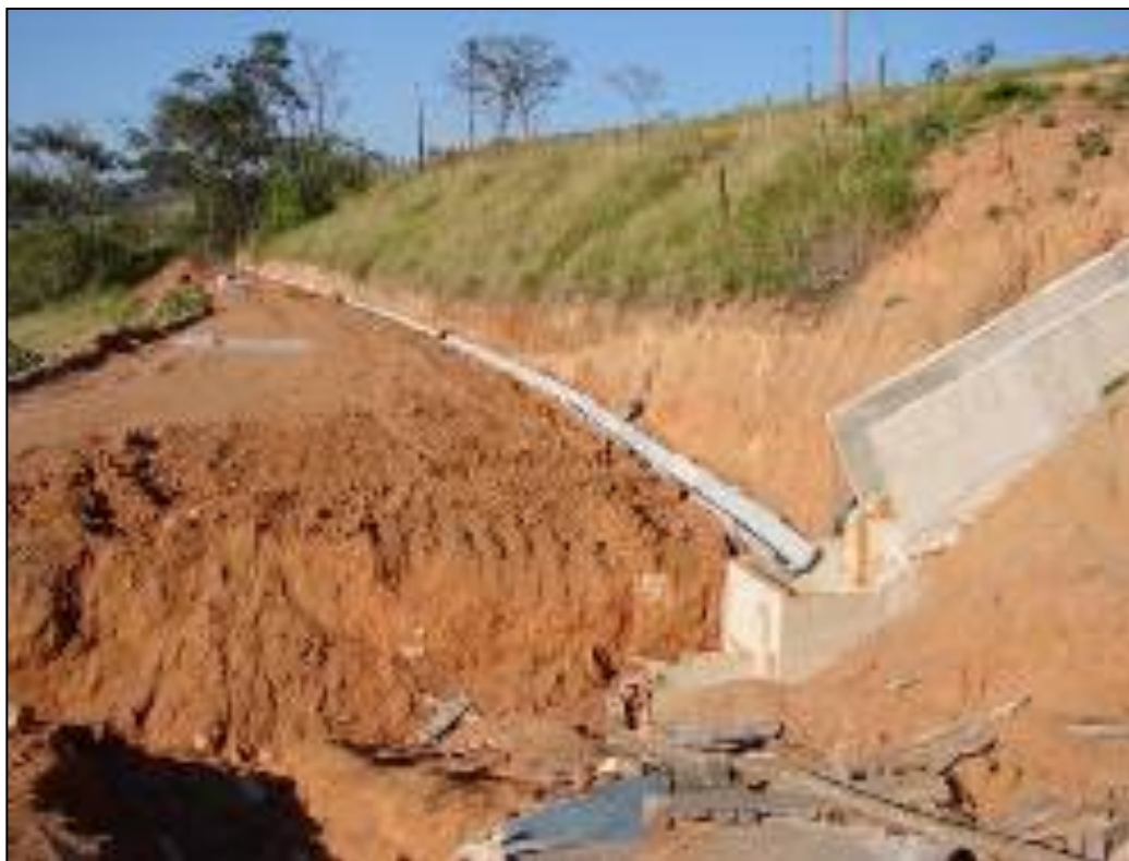
Figura 13 – Vista frontal da canaleta de águas pluviais e lateral da caixa de passagem e da escada hidráulica.
