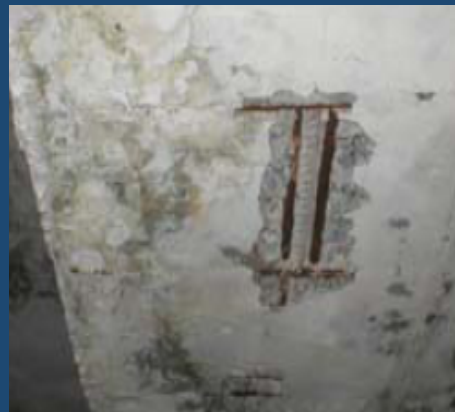
Falta de cobrimento
