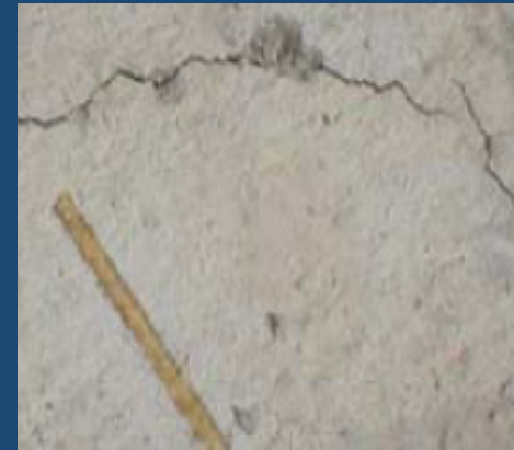
Trincas e fissuras
