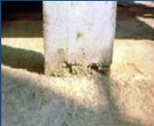
Vazios de concretagem – “bicheiras”
