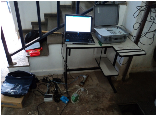
Figura 7 – Medição de vazão (medidor ultrassônico)
