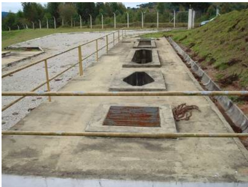
Figura 2: Tratamento preliminar (gradeamento e caixa de areia) sem armazenamento de resíduos antes da aplicação de auditoria housekeeping .
