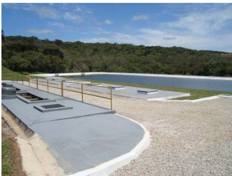
Figura 3: Tratamento preliminar (gradeamento e caixa de areia) com armazenamento de resíduos após aplicação de auditoria housekeeping .
