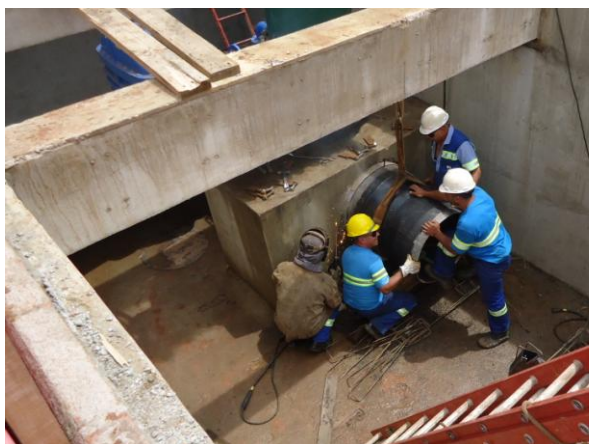
Figura 49 – Preparação e ajustes para montagem do conjunto de válvulas do “by-pass” do booster.
