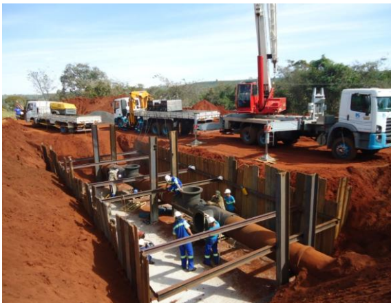
Figura 16 – Posicionamento e montagem dos “Tês” com DN 700 mm, necessários para interligação do booster e instalação do conjunto de válvulas do “by-pass”.
