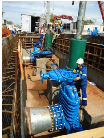
Figura 26 – Intervenção Programada: Início da inserção dos bloqueadores e operação do conjunto moto-bomba do novo booster.
