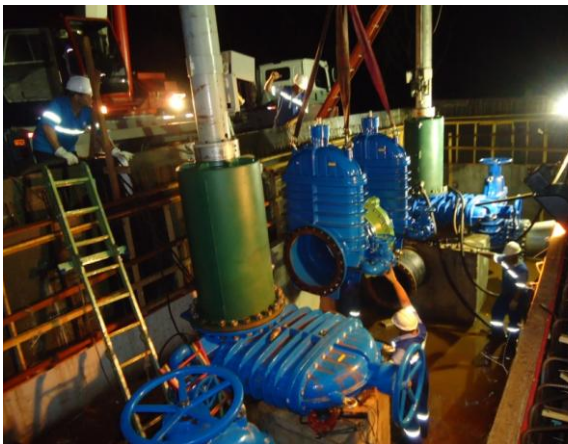
Figura 32 – Içamento e posicionamento do conjunto DN 700mm do “by-pass” do booster, contendo válvulas gavetas, válvula de retenção e junta de expansão..
