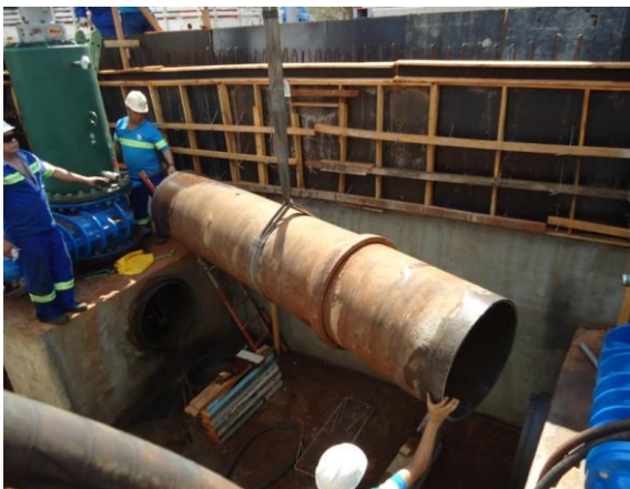
Figura 28 – Corte e retirada do segmento de tubulação com DN 700 mm entre os bloqueadores hidráulicos para instalação do conjunto de válvulas do "by-pass" do booster.
