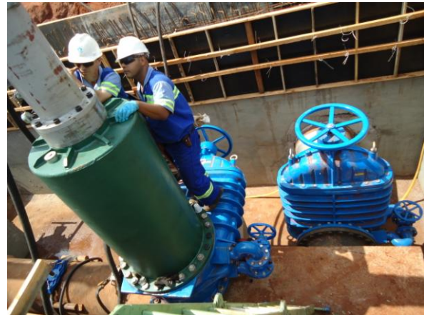
Figura 27 – Finalização da inserção dos bloqueadores hidráulicos e liberação para corte da adutora.
