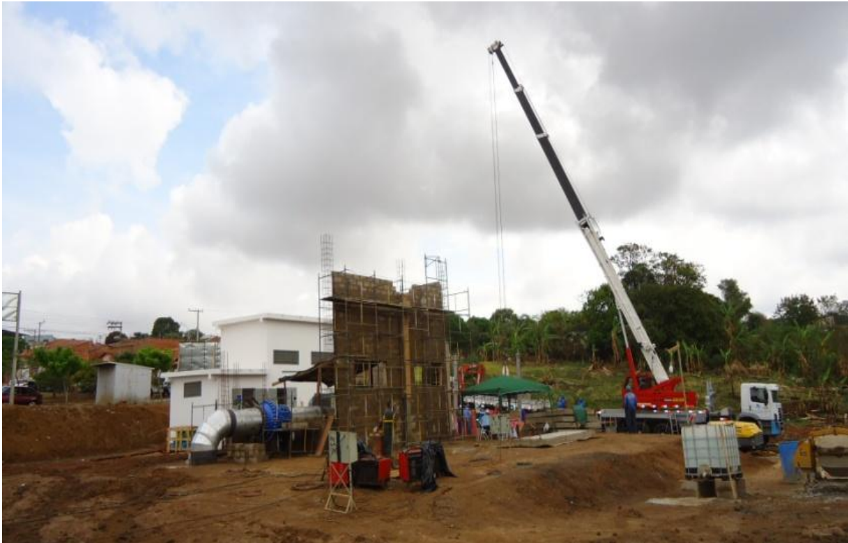
Figura 36 – Vista Geral do Booster Canoas II.
