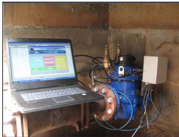
Figura 3: Instalação Válvula medidora redutora – modelo 920
