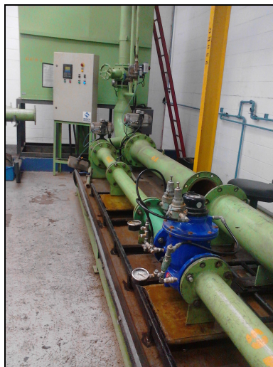
Figura 5: VRP medidora em teste do hidrômetro
