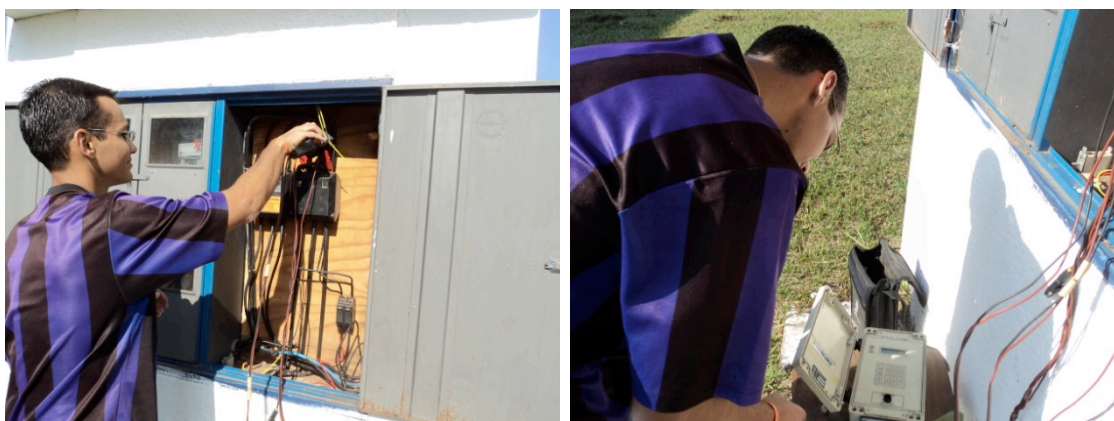
Figura 6 - Instalação do medidor de grandezas elétricas para monitoramento da demanda na ETA.
