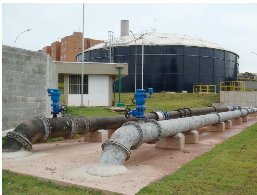
Figura 11 – Foto do centro de reservação Carmo em operação.
