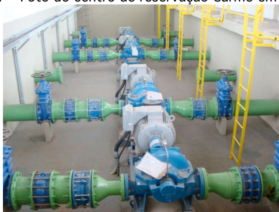
Figura 12 – Conjuntos elevatórios da EEAT Carmosina e Gleba do Pêssego em operação.
