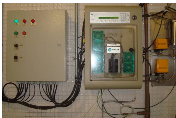
Figura 7 – Analisador de Sulfeto em solução líquida instalado na EPC Santos – Metrohn/Pensalab Manutenção e operação do equipamento instalado na EPC de Santos
