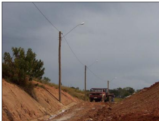
Figura 19 é Vista parcial dos postes de iluminação.
