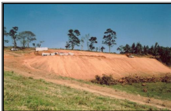
Figura 4 ó Vista efetuada a partir do local em que foi implantada a via de acesso lateral que permite chegar até as células iniciais de disposição de lixo.
