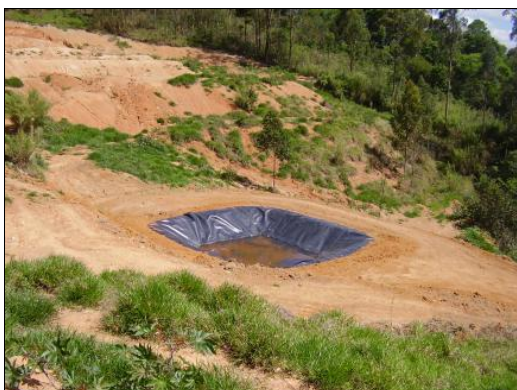
Figura 28 é Vista geral do segundo tanque de acúmulo de chorume.
