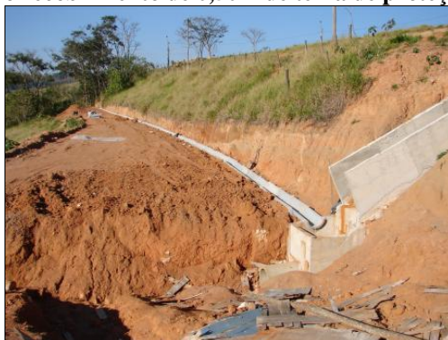
Figura 25 ó Vista frontal da canaleta de águas pluviais e vista lateral da caixa de passagem e da escada hidráulica.
