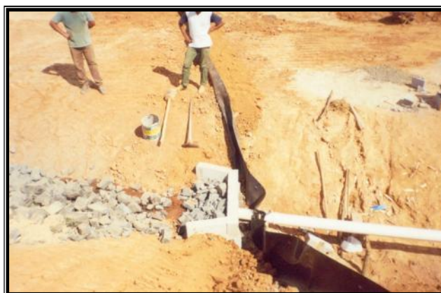
Figura 8 ó Vista parcial da caixa de contenção dos drenos de percolados e em detalhe a implantação da manta de geomembrana, de forma a evitar a saída do chorume gerado.
