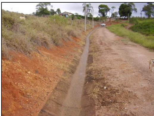
Figura 13 ó Vista geral da canaleta de águas pluviais e da estrada de acesso à 1ª célula, de jusante para montante.
