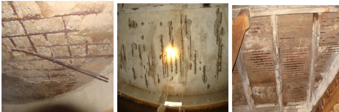
Figura 7: Anomalias Típicas de Regiões com Corrosão de Armaduras
