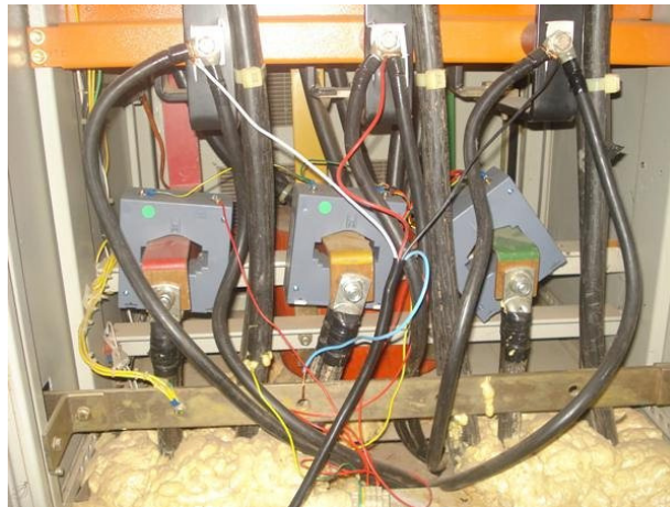
FIG 3- Transformador de corrente e de tensão
