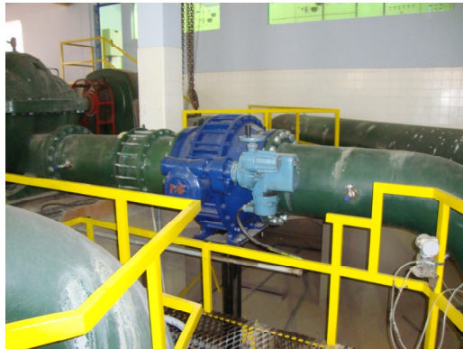
FIG 2- Vista da válvula esfera e tomadas de pressão (P1 e P2).
