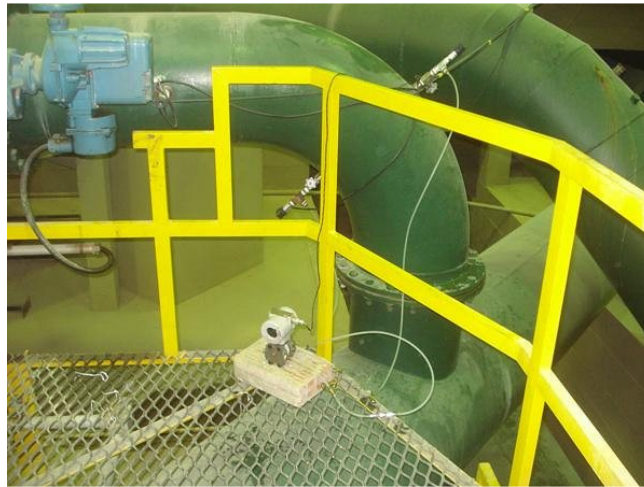
FIG 1- Vista do medidor de vazão tipo cotovelo de 90 °.
