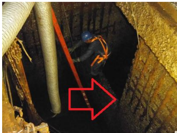
Figura 4 - Corrosão em uma EEE instalado na cidade de Cubatão/SP - Ferragens expostas, situação em 2013 – Fonte: Sena, s.publ.
