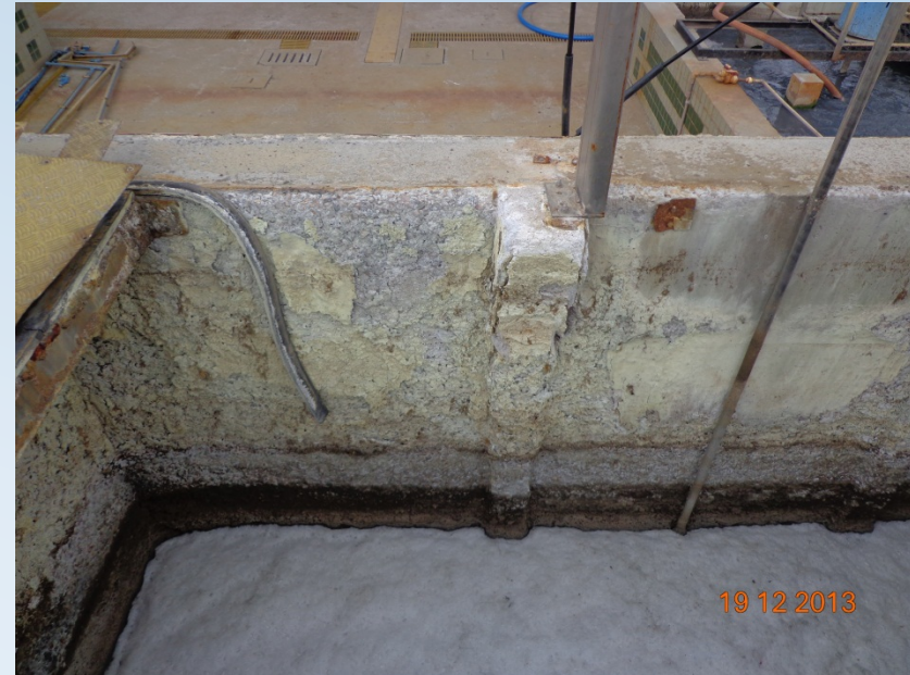
Reator UASB – ETE Atuba - Paraná
