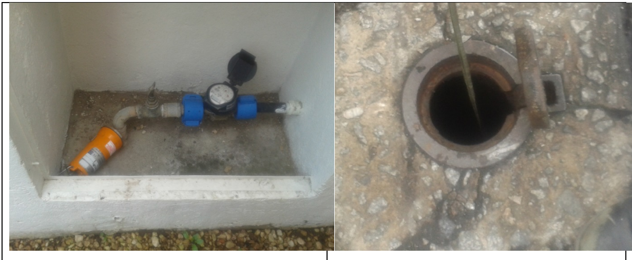
Figura 4: Planta utilizada em campo com cadastro técnico do SIGNOS da área com suspeita de vazamento em 29/05/2013 na Rua Pais Barreto.
