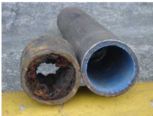
Figura10: Comparação do estado estrutural da rede, antes e depois dos serviços.
