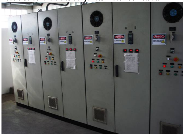
Figura 11 - Painéis elétricos e de controle dos conjuntos motor bomba da EEA Mutinga
