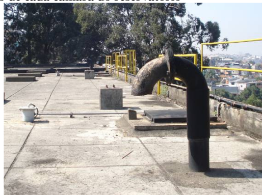
Figura 23 – Acesso e respiro de cada câmara do reservatório
