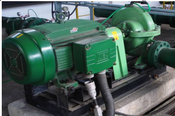
Figura 10 - Um dos conjuntos motor bomba instalado na EEA Mutinga
