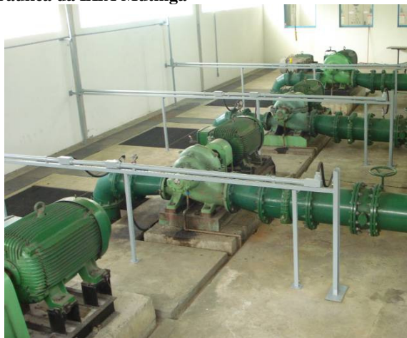
Figura 9 - Instalação hidráulica da EEA Mutinga
